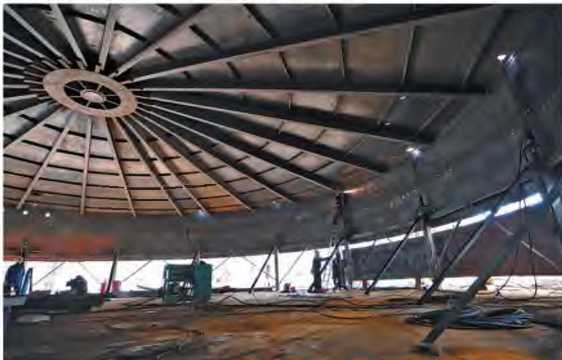
– Ёмкость собирают сверху вниз, – рассказал начальник отделения химводоочистки. – Купол крыши с помощью гидравлических домкратов приподняли от земли, приварили металлический пояс шириной 1,5 метра. Снова приподняли – добавили еще один пояс. Всего восемь таких элементов конструкции. Параллельно идет технологическая обвязка ёмкости трубопроводами, специалисты службы подготовки новых производств проверяют качество сварных соединений. Ожидаем ввода в строй к концу мая
